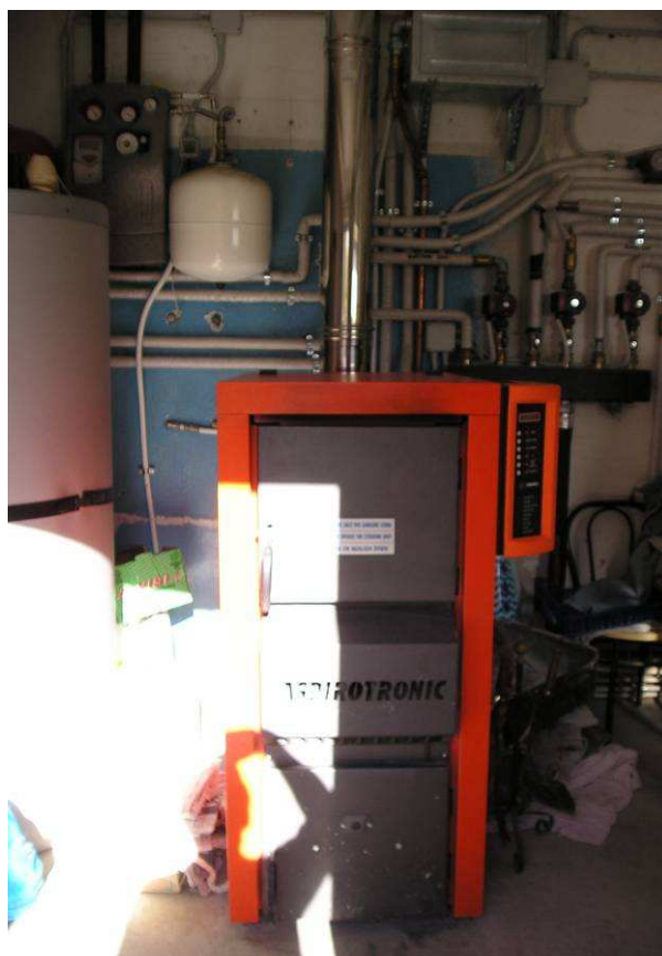
caldaia a legna
