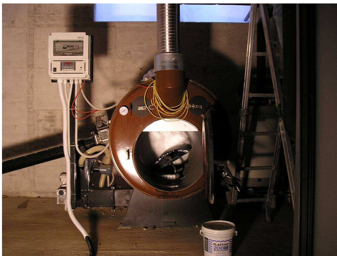
Particolare vano alimentazione manuale caldaia
